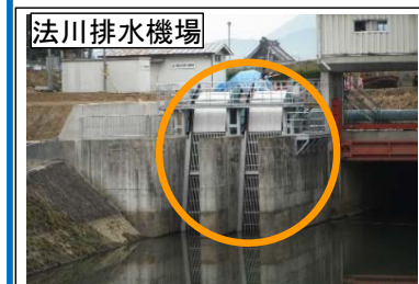
緊急排水ポンプ(3.0m 3 /s) 増強ポンプ完成(H29.3)
